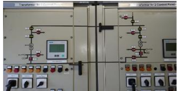
132 000 VOLT SWITCHING PANEL
